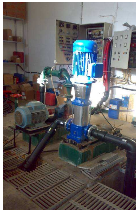
Imagem 6 – Electrobomba da Hidropressora
