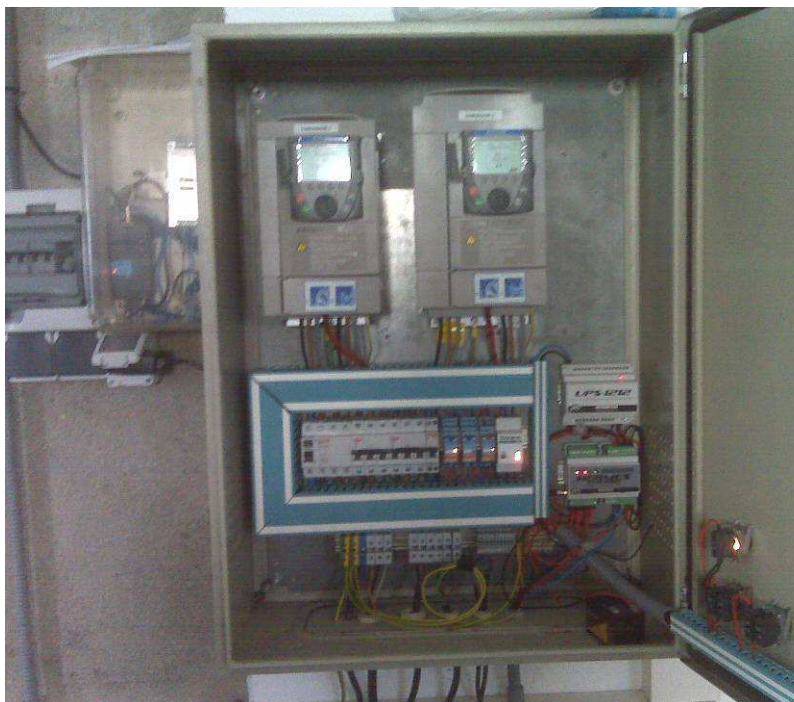
Imagem 5 – Quadro eléctrico do depósito de Degolados
