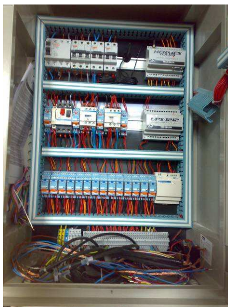
Imagem 2 – Quadro eléctrico da Telegestão dos depósitos da Eira do David
