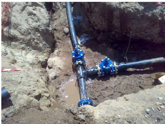
Imagem 11 – Válvulas de seccionamento
