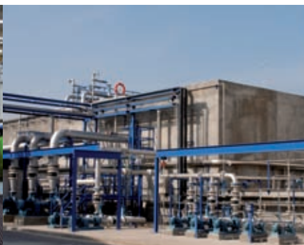
Central de manutenção da aqualia Industrial .
