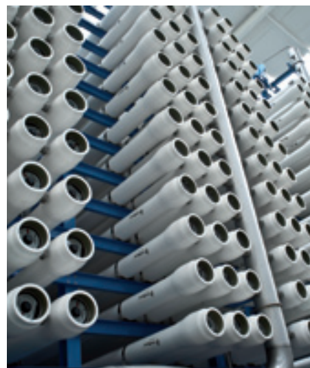
Bastidor de membranas da instalação Dessalinizadora de CapDjinet.
