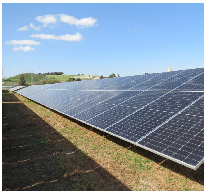
● Painéis solares instalados na ETAR de Jerez de la Frontera, Espanha.
